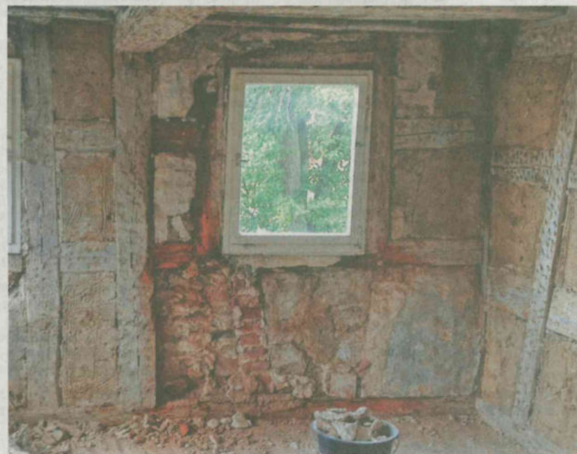
Ein Blick ins Innere vor der Sanierung. Die Wiederherstellung kostet nicht nur Zeit, sondern auch viel Geld, das man sich von der Bank leihen muss.
